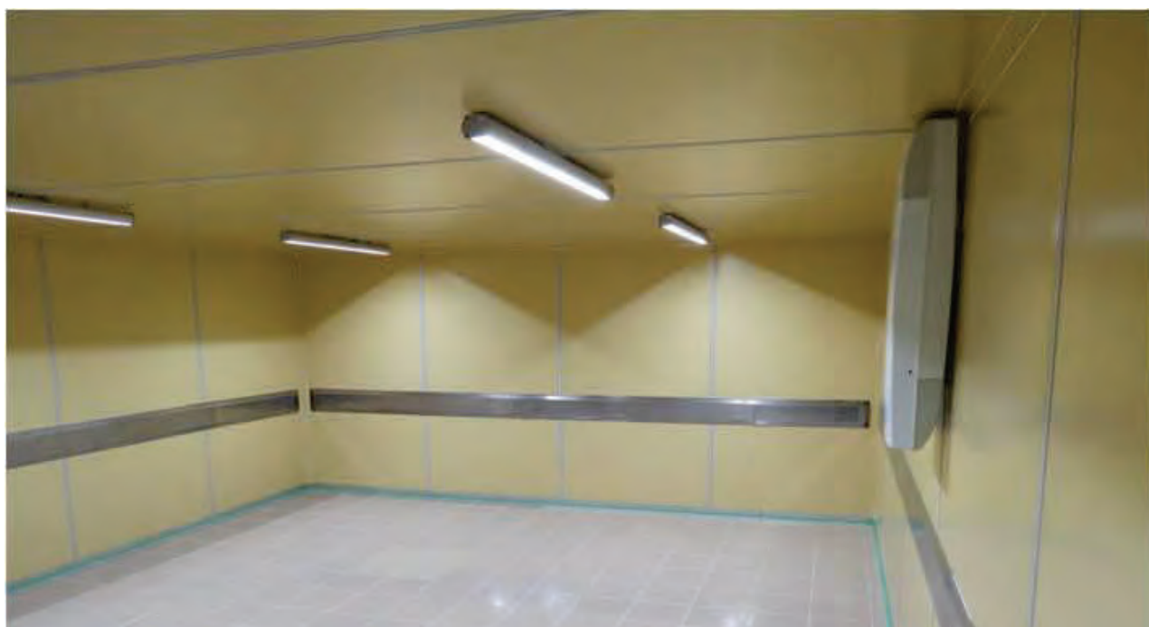
Рис. 8, 9. Холодильная камера для хранения трупов.
